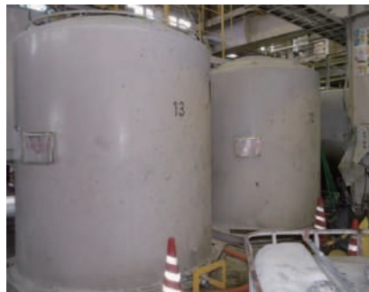
発酵処理タンク
