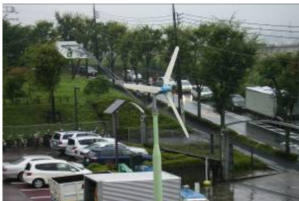
【風力発電機 エコプラザ多摩内】
