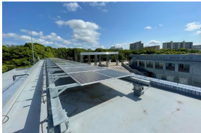
建物屋上の太陽光パネル
