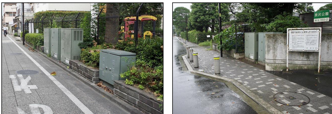
写真-6 公園等の公共用地を活用して地上機器を設置した例（立川市内、福生市内）
