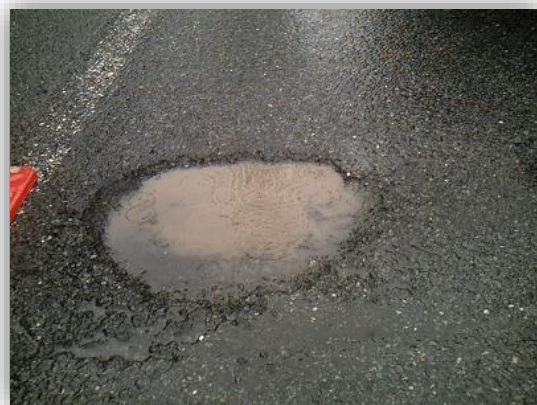
写真-4 ポットホールの例
