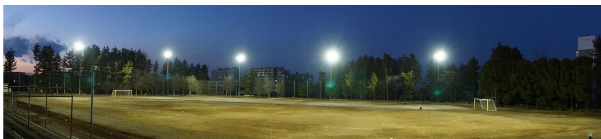
LED照明灯に改修された多摩永山中学校の校庭夜間照明設備
