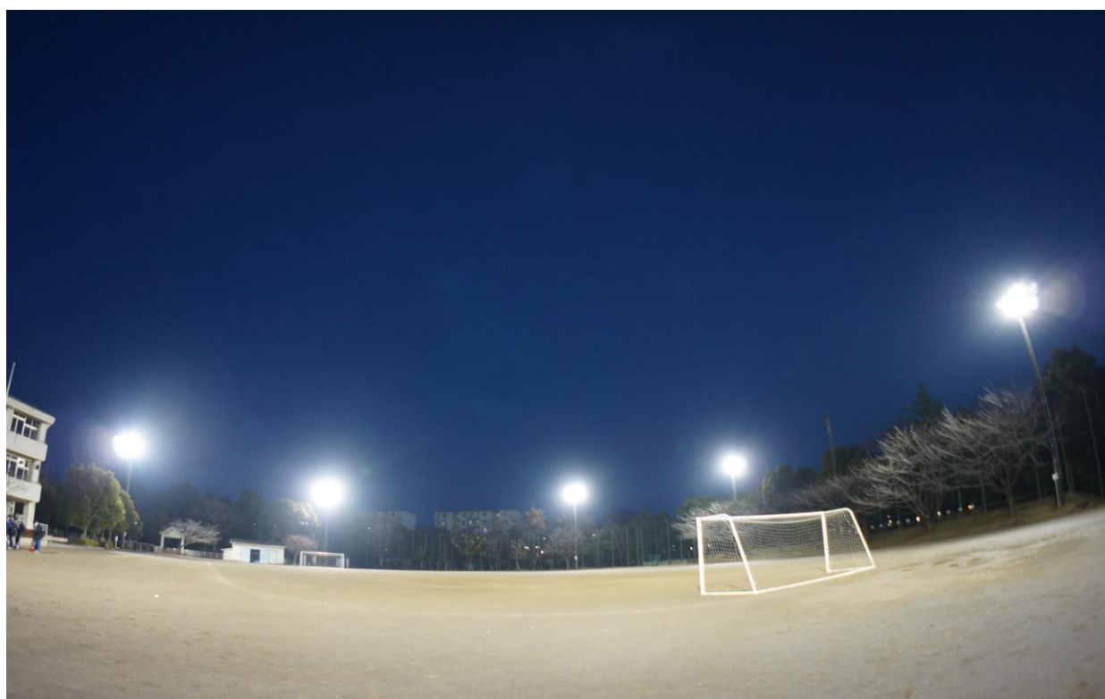
LED照明灯に改修された鶴牧中学校の校庭夜間照明設備
