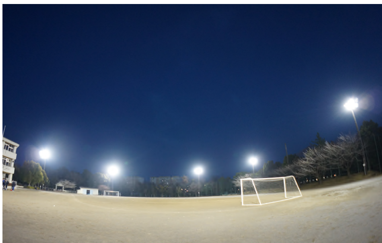
L E D 照明灯に改修された鶴牧中学校の校庭夜間照明設備
