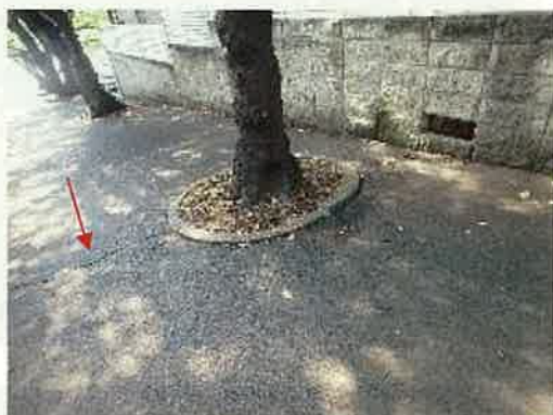
根上りによる車いす 等の走行性悪化
