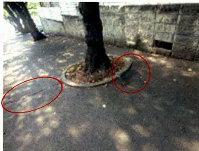
根上がりにより舗装や縁石が浮き上がった状況
