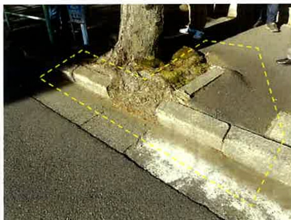
根上がりにより舗装や縁石が持ち上がった状況
