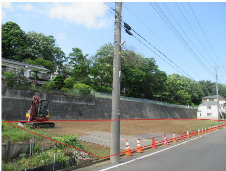
行為制限解除後の状況
