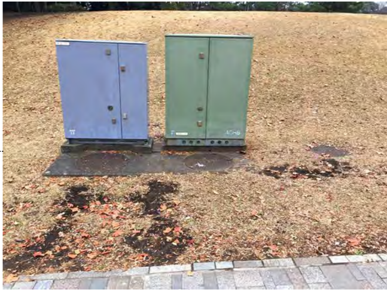
⑬ 歩専道から、敷地内西側の給電引込みボックス。
