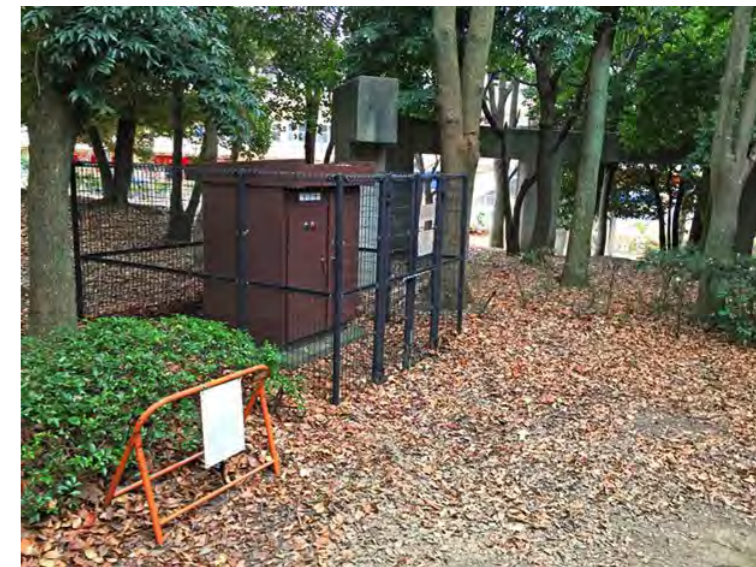
⑲ 敷地内の野外トイレ裏側の給電幹線開閉器。
