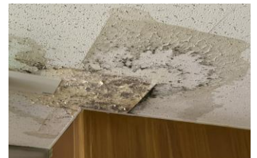
老朽化した天井の様子
