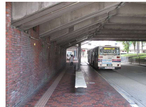
壁面、桁下の劣化状況
