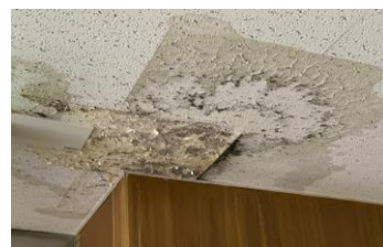
老朽化した天井の様子
