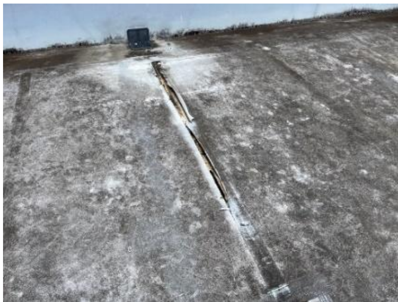
屋上防水の緩衝シート部亀裂
