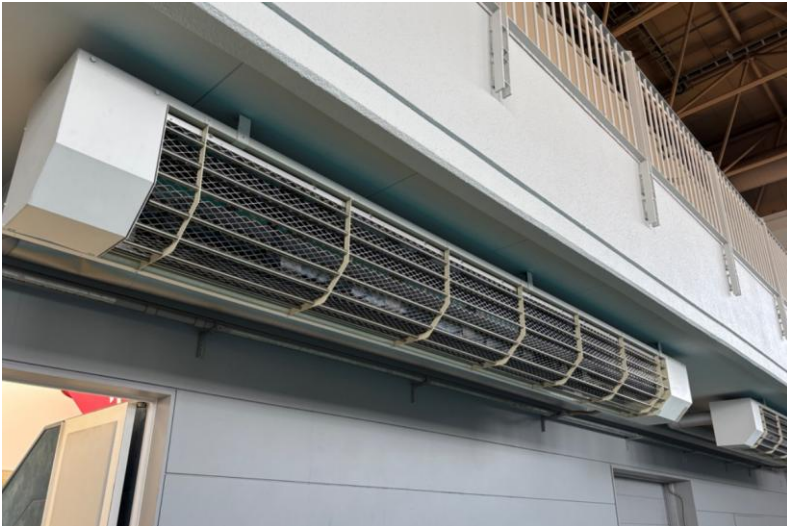
第2SH2階部分のランニングコース下部のヒ-タ-の箇所に設置
